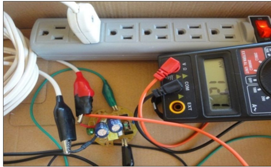
Figura 55. Suministro de 120 V de la red eléctrica al balastro electrónico Fuente: Investigador
