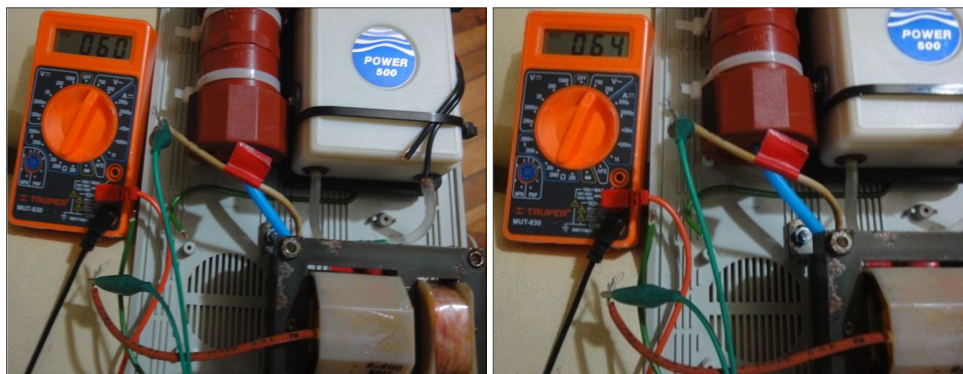
Figura 66. Incomprensibles valores de alto voltaje registrado en el multímetro digital Fuente: Investigador
