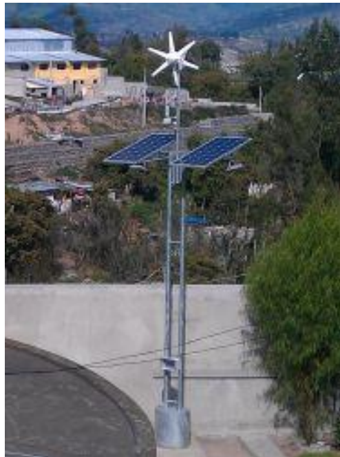
Fig. 1.11 Poste de Iluminación [6]
