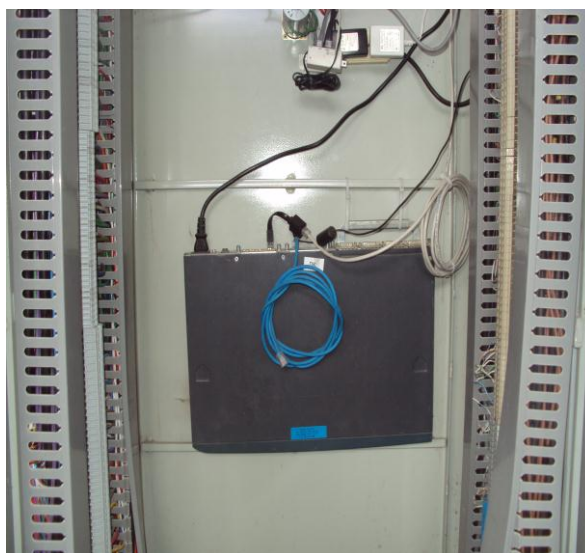
Figura 6.16. Figura del Armario con el Transductor Empresa Eléctrica Ambato S.A.
