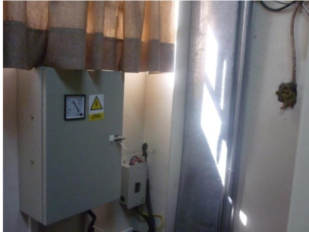
Figura N° 6.18: Caja de control eléctrico Elaborado por: Diana Córdova Fuente: Investigación de campo
