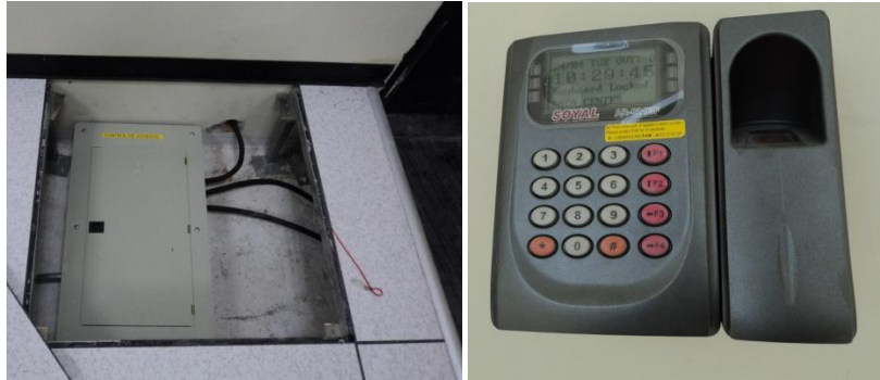
Figura N° 6.36: Sistema biométrico Fuente: Investigación de campo
