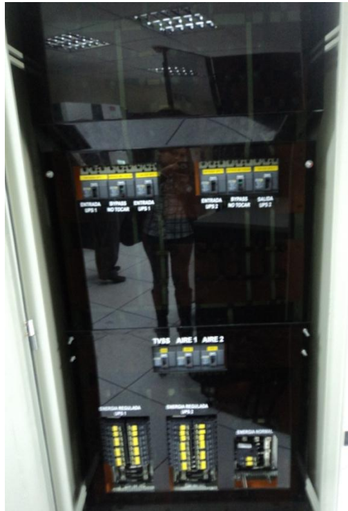
Figura N° 6.55: Tablero Eléctrico Fuente: Investigación de campo
