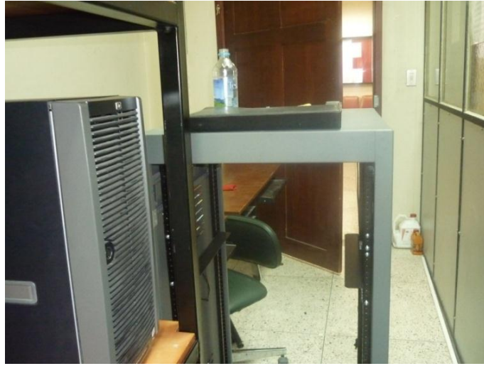
Figura N° 6.11: Ingreso al área de servidores Elaborado por: Diana Córdova Fuente: Investigación de campo
