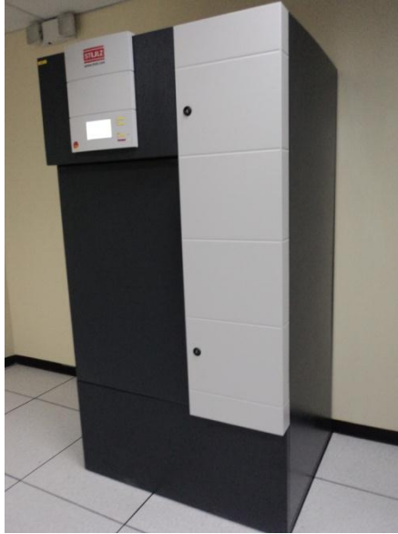
Figura N° 6.39: Aire acondicionado de precisión Fuente: Investigación de campo
