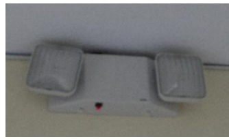
Figura N° 6.34: Lámpara de emergencia Fuente: Investigación de campo
