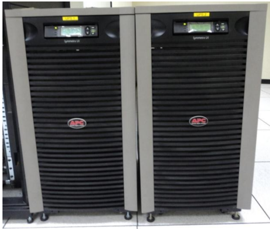
Figura N° 6.53: UPS Fuente: Investigación de campo
