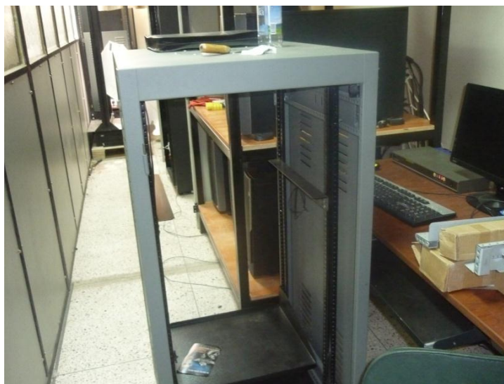
Figura N° 6.23: Espacio del área de servidores
