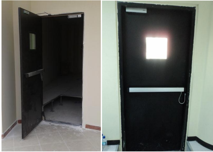
Figura N° 6.35: Puerta de seguridad Fuente: Investigación de campo
