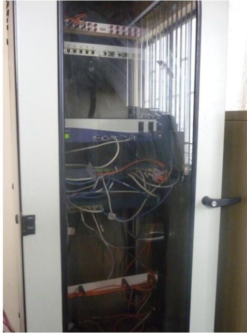
Figura N° 6.30: Rack Ingahurco Elaborado por: Diana Córdova Fuente: Investigación de campo
