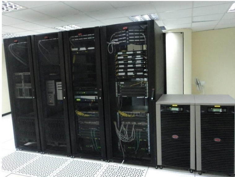
Figura D. Vista Frontal Data Center UNACH Fuente: Investigación de campo
