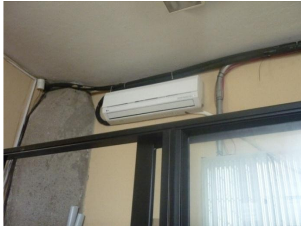
Figura N° 6.28: Aire acondicionado DISIR
