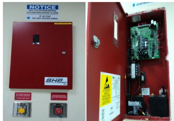
Figura N° 6.43: Consola o panel de control Fuente: Investigación de campo
