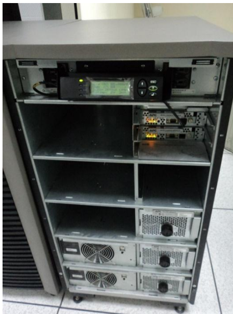
Figura N° 6.54: Baterías del UPS Fuente: Investigación de campo
