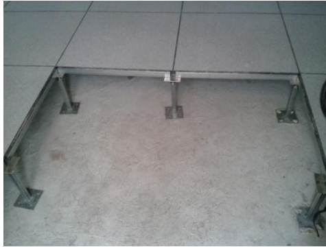
Figura N° 6.46: Piso Falso Metálico Antiestático Fuente: Investigación de campo
