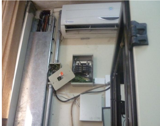
Figura N° 6.16: Sistema de aire acondicionado de confort Elaborado por: Diana Córdova Fuente: Investigación de campo
