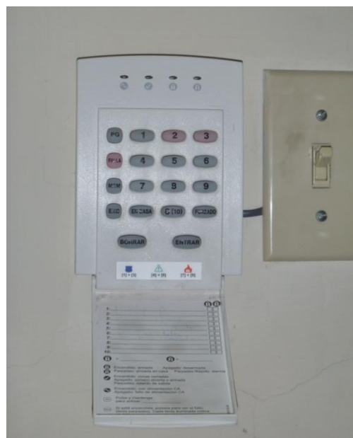
Figura N° 4.11. Tablero de control Elaborado por: La Investigadora
