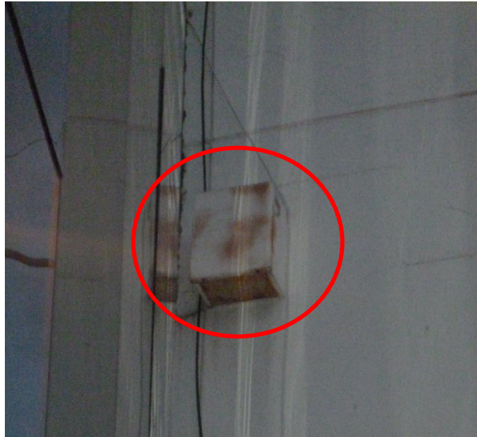
Figura N° 4.10. Sirena ubicada en el edificio principal de la facultad Elaborado por: La Investigadora
