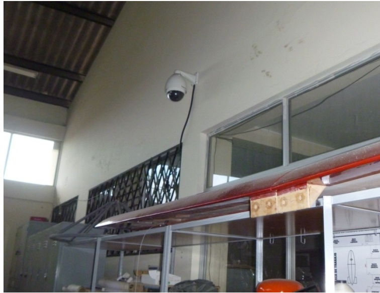
Vista de la ubicación de la cámara PTZ Elaborado por: La Investigadora
