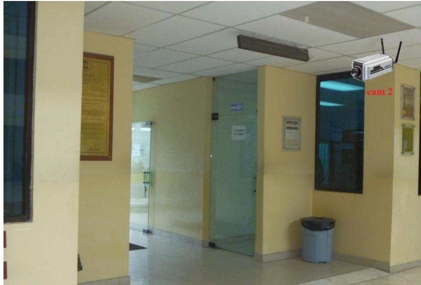
Figura N° 6.24. Cámara 2 ubicada en la entrada al ágora del edificio principal Elaborado por: La Investigadora
