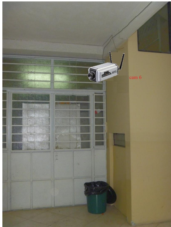
Figura N° 6.25. Cámara 6 ubicada en la entrada secundaria al edificio principal Elaborado por: La Investigadora
