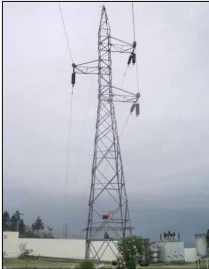
Figura 4.20.- Torre metálica de la S/E Cochabamba. Elaborado por: El Investigador.
