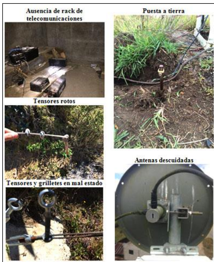
Figura 4.6.- Estado físico de equipos y materiales. Elaborado por: El Investigador.
