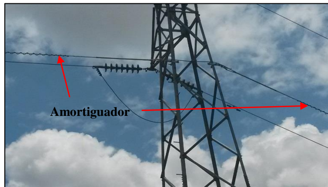
Figura 4.23.- Amortiguador en cable óptico ruta Guaranda-Riobamba propiedad de TRANSELECTRIC. Elaborado por: El Investigador.
