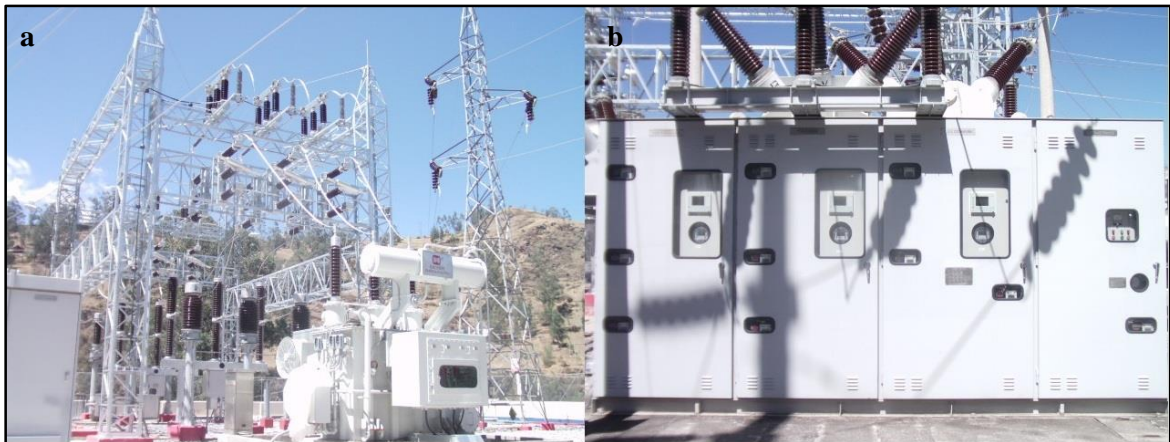
Figura 4.3.- Subestación de intemperie (a). Subestación GIS (b).
