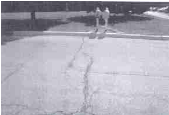
FOTO No. 2.9.- Fisuramiento en Bloque – Severidad Alta
