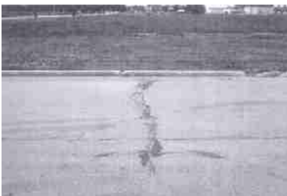
FOTO No. 2.30.- Falla Fisuramiento Longitudinal y/o Transversal – Severidad Alta
