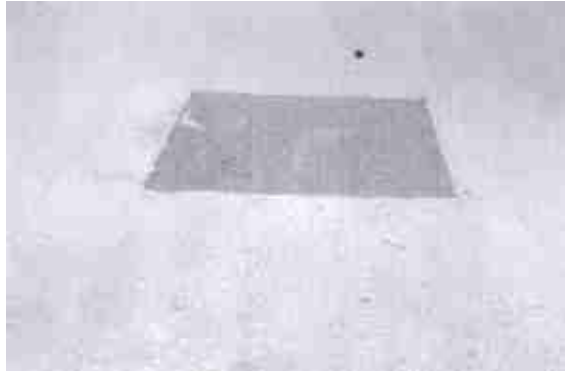
FOTO No. 2.31.- Falla Parche – Severidad Baja
