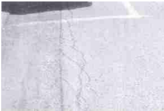
FOTO No. 2.21.- Falla Fisuramiento en Borde – Severidad Alta
