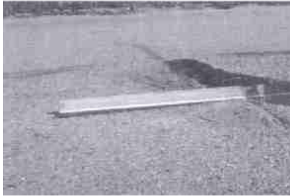
FOTO No. 2.11.- Falla Desnivel Localizado – Severidad Media
