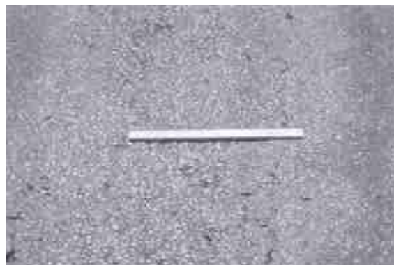
FOTO No. 2.51.- Falla Intemperismo – Severidad Baja
