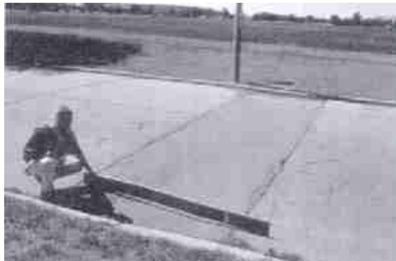
FOTO No. 2.33.- Falla Parche – Severidad Alta
