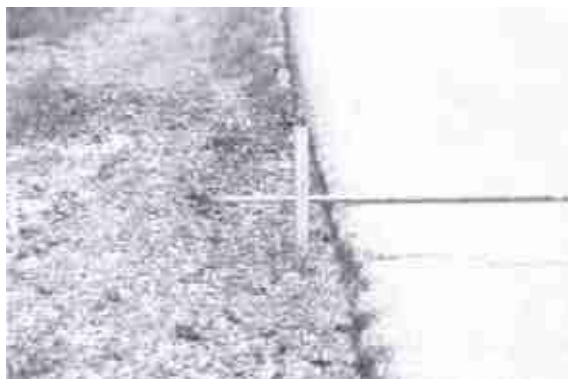
FOTO No. 2.28.- Falla Fisuramiento Longitudinal y/o Transversal – Severidad Baja
