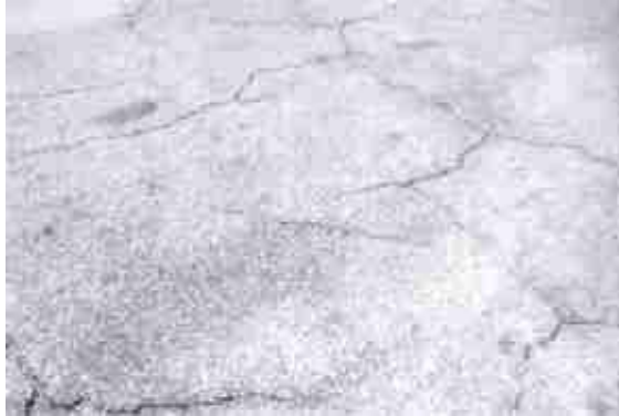
FOTO No. 2.8.- Fisuramiento en Bloque – Severidad Media
