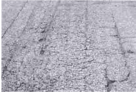
FOTO No. 2.53.- Falla Intemperismo – Severidad Alta
