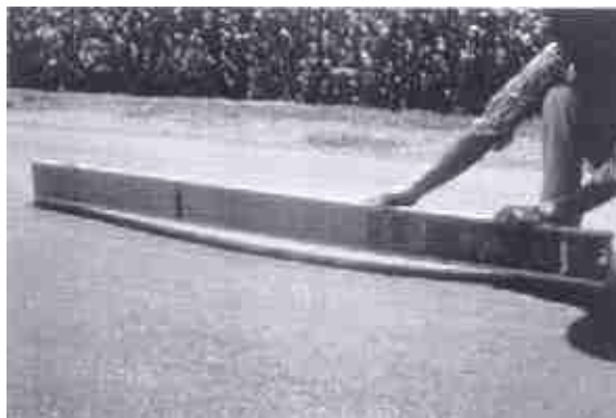
FOTO No. 2.18.- Falla Depresión – Severidad Alta
