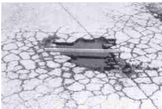
FOTO No. 2.37.- Falla Bache – Severidad Alta
