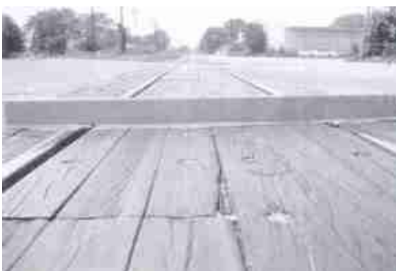
FOTO No. 2.38.- Falla Cruce de Ferrocarril – Severidad Baja
