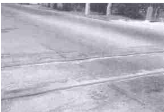
FOTO No. 2.39.- Falla Cruce de Ferrocarril – Severidad Media
