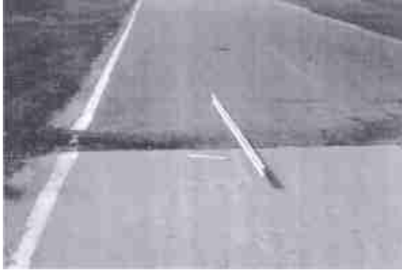
FOTO No. 2.47.- Falla Fisuramiento de Resbalamiento – Severidad Baja
