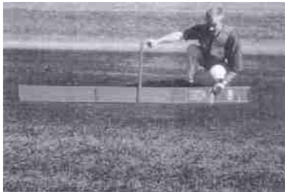
FOTO No. 2.17.- Falla Depresión – Severidad Media
