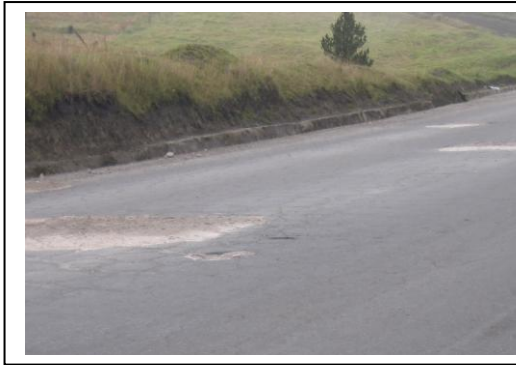
33+900.- MANTENIMIENTO INADECUADO: BACHES TAPADOS CON LASTRE
