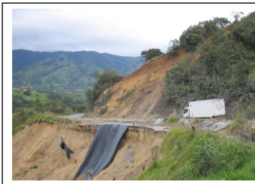
138+200.- TRAMO SIN MANTENIMIENTO (120+000 – 160+000)
