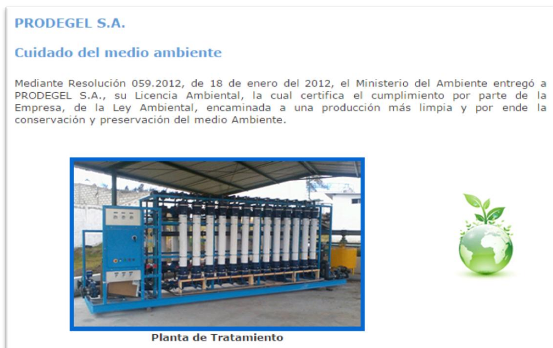
Figura No.15: Exigencias ambientales. Planta de tratamiento de aguas PTAR
