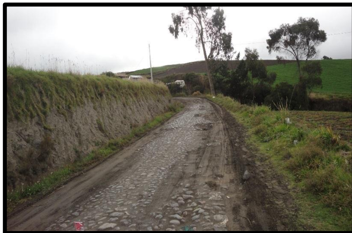
Ilustración 9: Empedrado en mal estado
