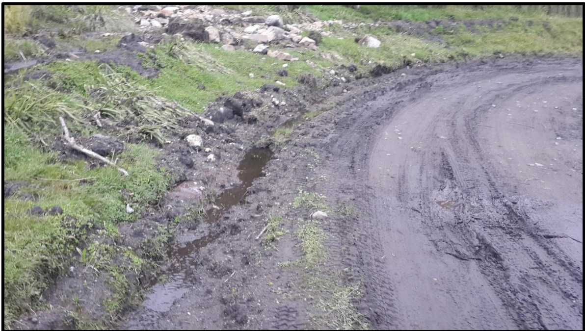
IMAGEN 4.- FALTA DE CUNETAS
