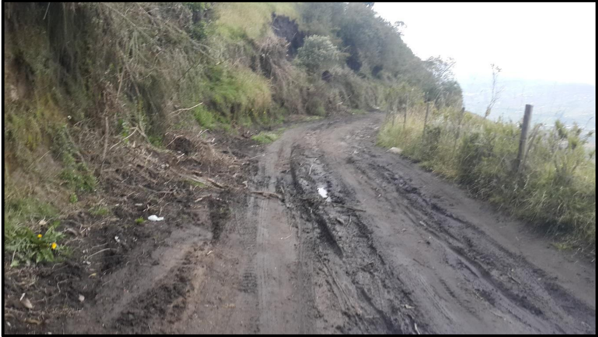
IMAGEN 3.- VÍA EN MAL ESTADO POR LA INEXISTENCIA DE DRENAJE
