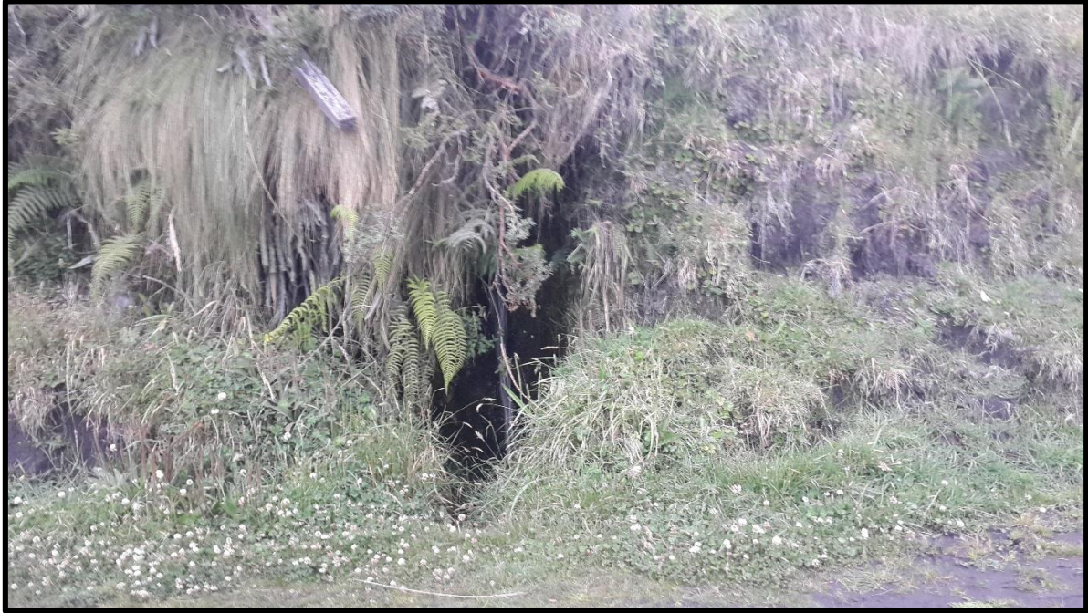
IMAGEN 5.- NIVEL FREÁTICO ALTO
