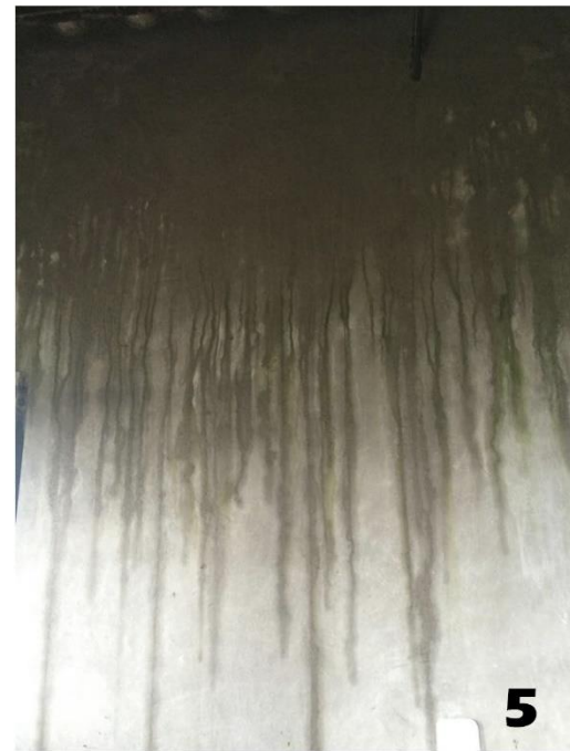
HUMEDAD - SALA ESTADO ACTUAL
