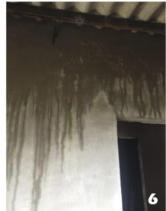
HUMEDAD - INGRESO ESTADO ACTUAL
