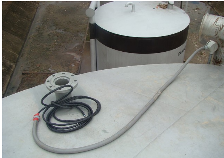
Figura 5.40. Acometida en el Tanque
