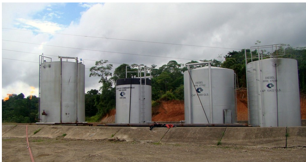
Figura 4.1. Tanques de Diesel de la Central de Generación
