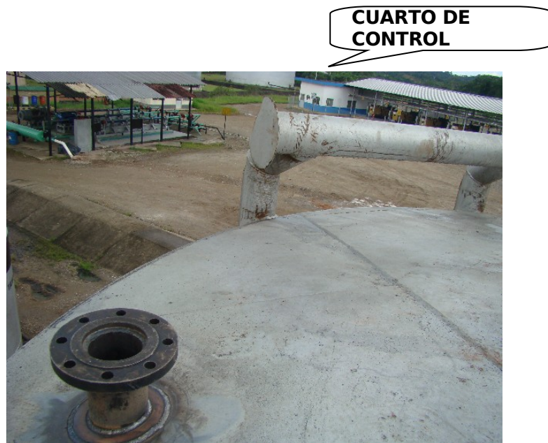
Figura 5.30. Enfoque Tanque-Cuarto de Control
