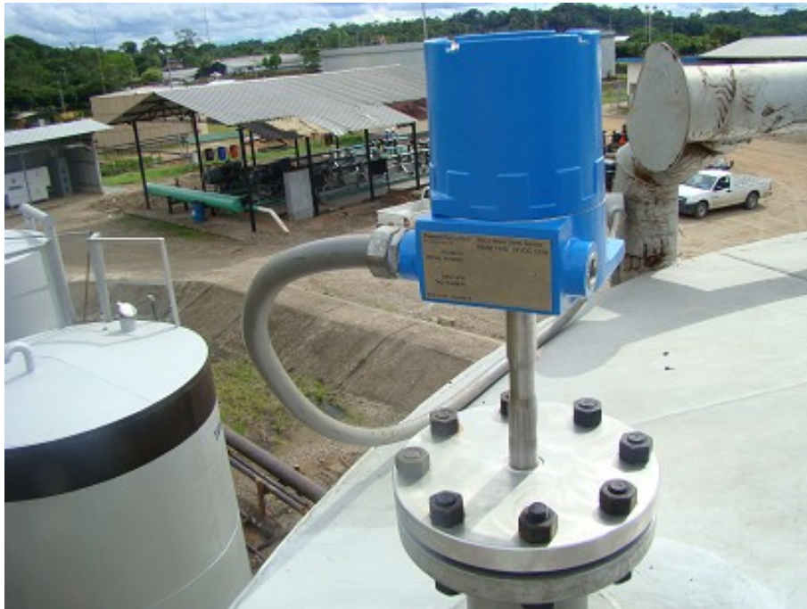
Figura 5.52. Medidor instalado vista-frontal
