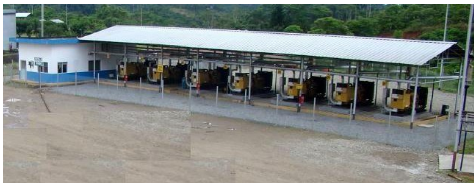
Figura 4.11. Central de Generación Cuyabeno
