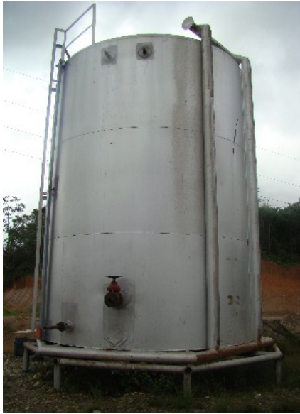
Figura 5.20. Tanque de almacenamiento Diesel
