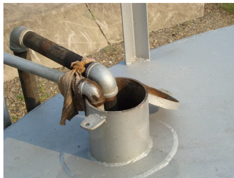
Figura 5.19. Tubería de Ingreso y Retorno Diesel
