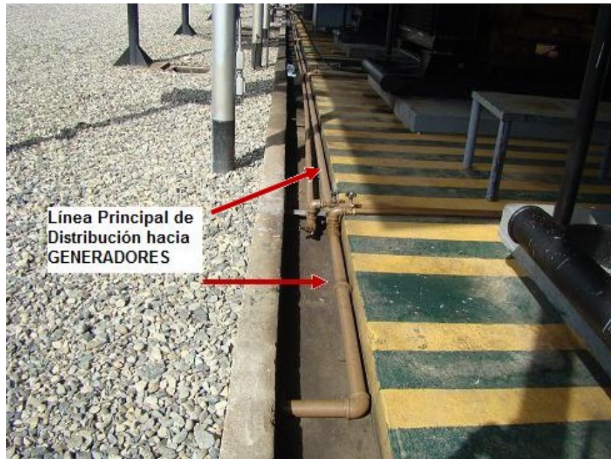
Figura 4.9. Distribución de Diesel (Generadores)
