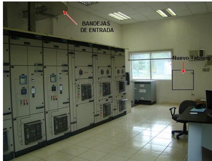
Figura 4.16. Tableros de Control
