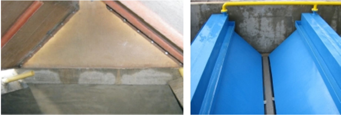
Figura N° 12.- Gasómetro de fibra de vidrio (campanas)
