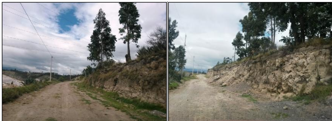
Taludes en la vía Chan – Tiobamba
