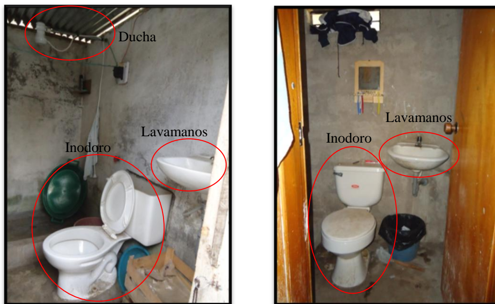
Foto N°1. Aparatos Sanitarios de los moradores del Caserío San Juan
