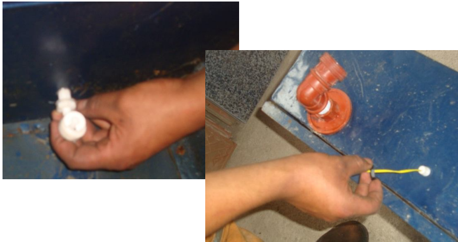
Figura 6.53. Instalación del sensor vertical de flotador.
