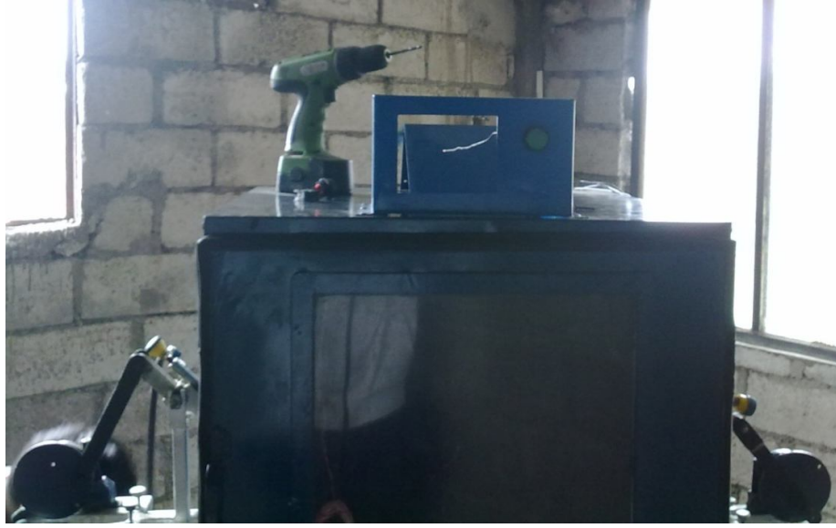
Figura 6.49. Empotramiento de la caja para gabinete de control. Elaborado por: El investigador
