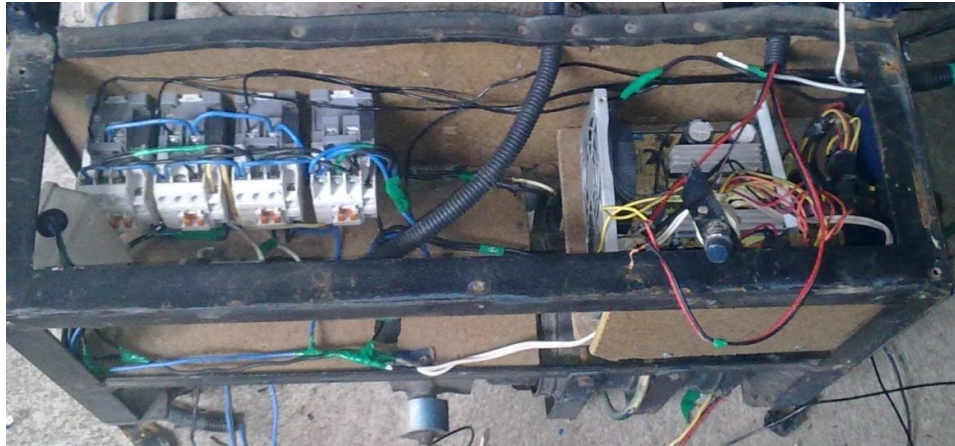
Figura 6.45. Cableado (salidas del PLC – bobinas de los contactores).
