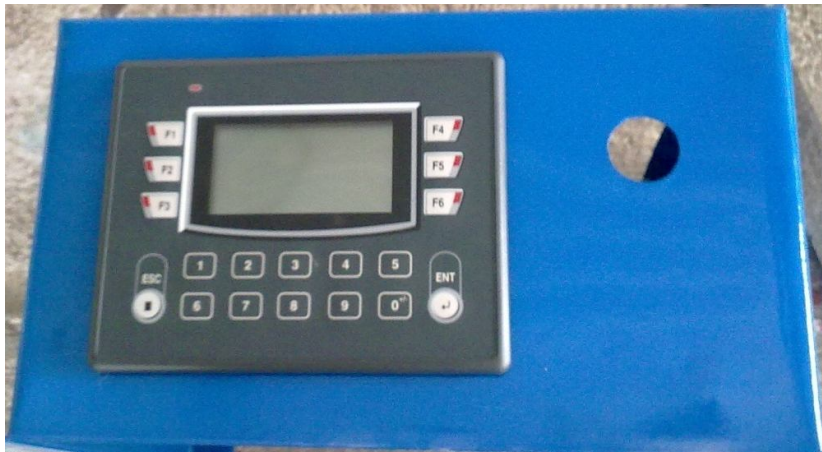
Figura 6.51. Empotramiento del PLC.
