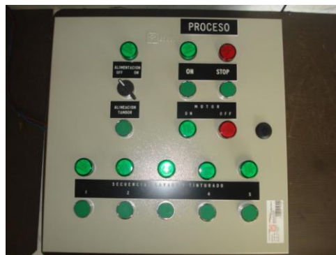
Figura 6.28 Tablero de control vista exterior
