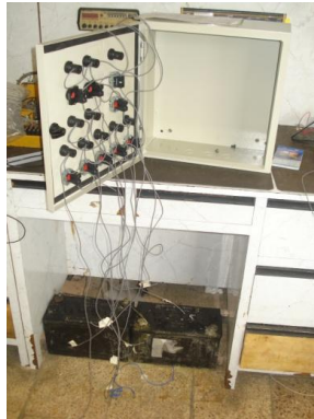
Figura 6.19 Cableado de las entradas al PLC
