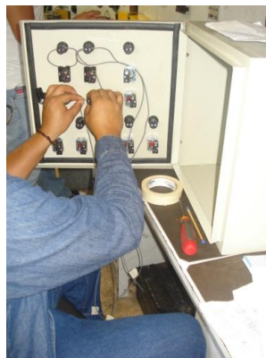
Figura 6.18 Cableado del panel de control
