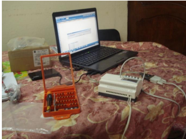
Figura 6.9 Transferencia del software al PLC Zelio
