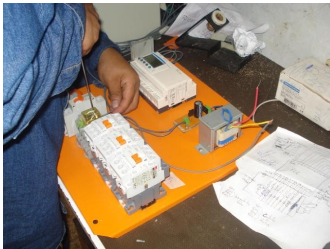
Figura 6.20 Cableado de los relés y contactores
