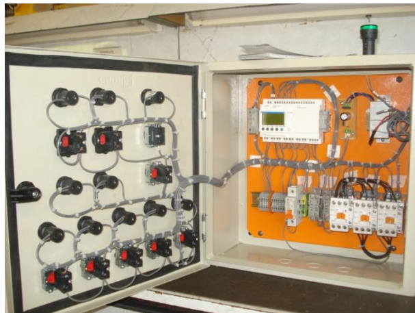
Figura 6.27 Tablero de control vista del cableado
