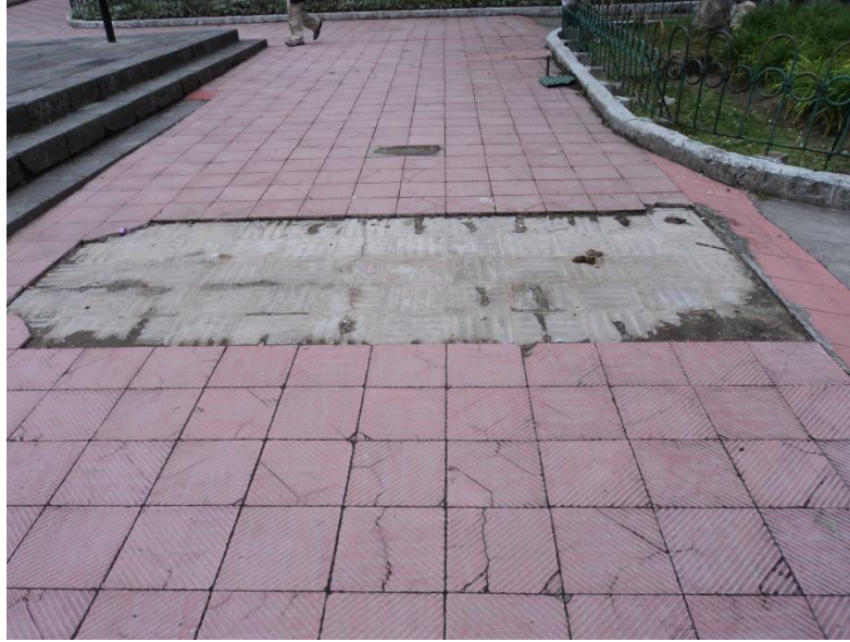
Fotografía 37 Piso en mal estado
