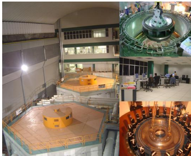
Figura 4.3. Central Hidroeléctrica San Francisco Fuente: CELEC EP – Hidroagoyán
