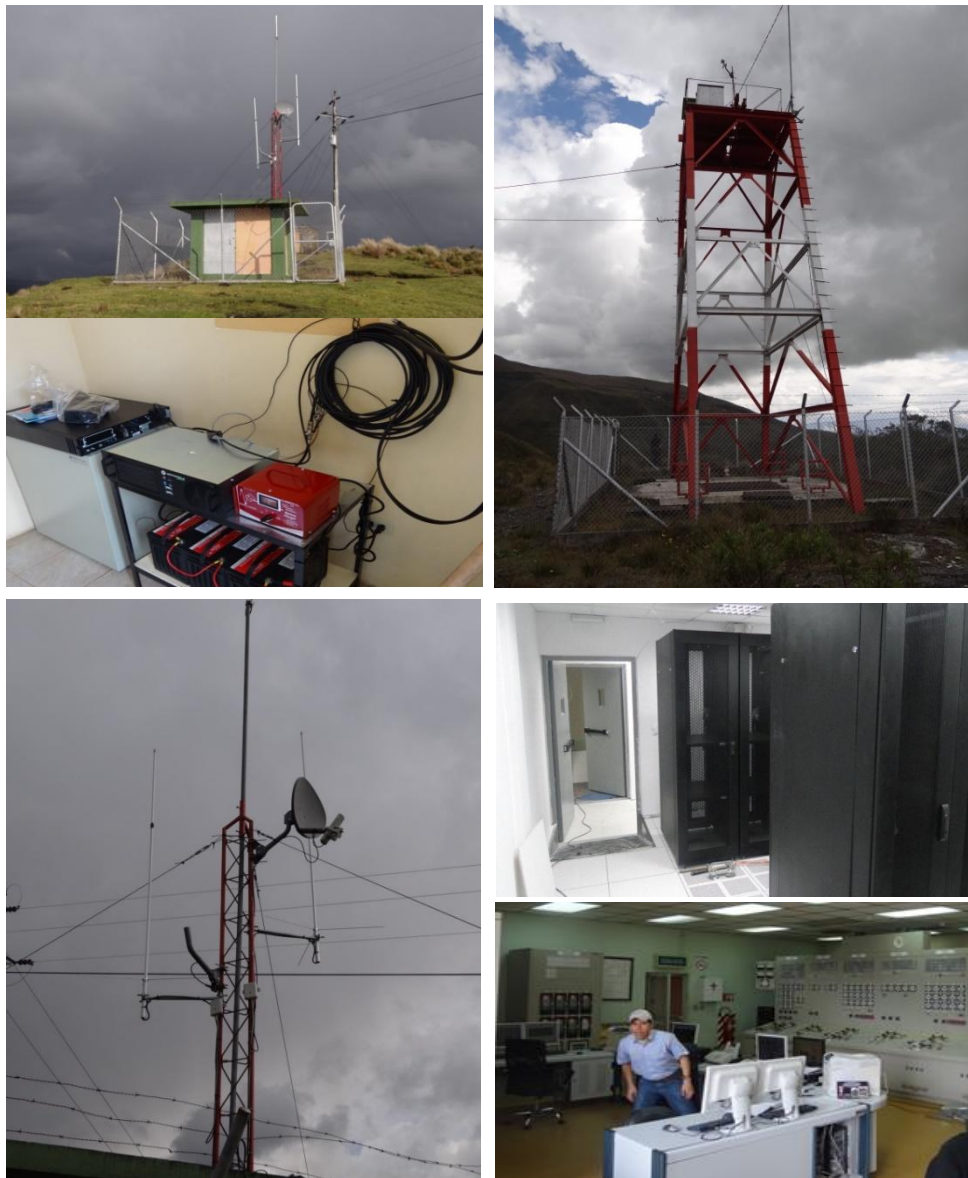
Figura 4.5. Fotografías de infraestructura de red e instalaciones Fuente: CELEC EP – Hidroagoyán
