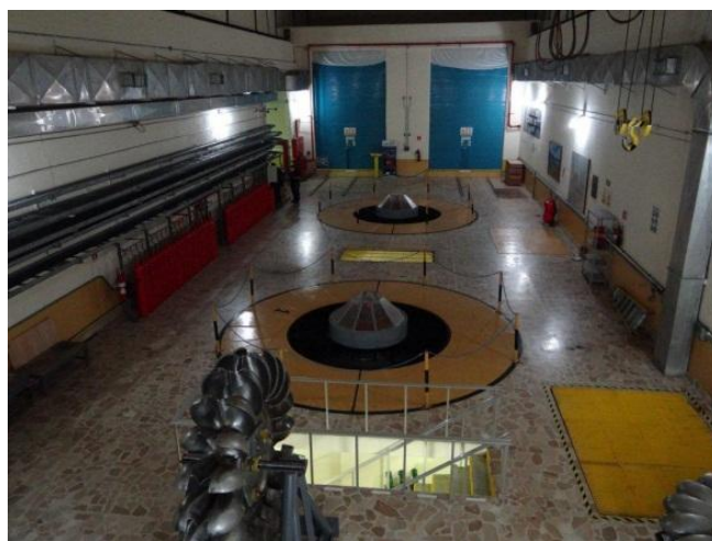
Figura 4.2. Central Hidroeléctrica Pucará Fuente: CELEC EP – Hidroagoyán
