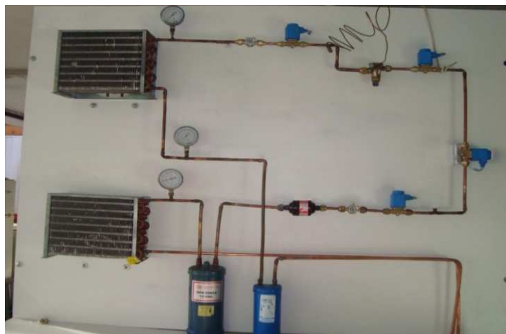
IMAGEN 6.26. Línea de baja, salida de evaporador - entrada de compresor.
