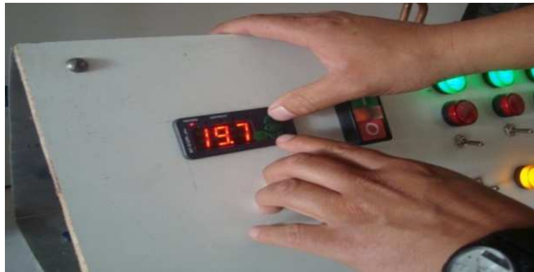
IMAGEN 6.38. Calibración del termostato digital.
