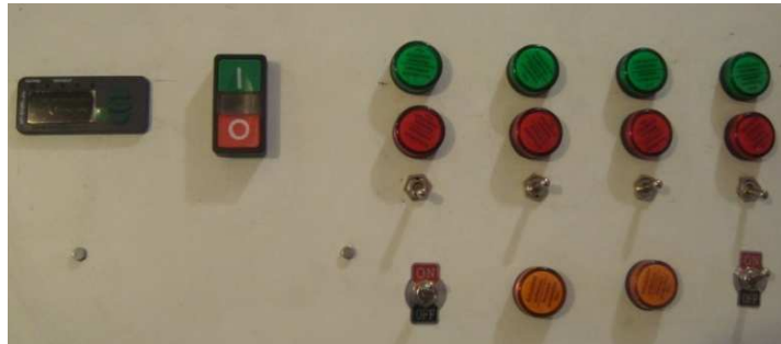
IMAGEN 6.19. Tablero de control (vista frontal).
