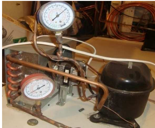
IMAGEN 6.31. Manómetros alta y baja presión de la unidad condensadora.
