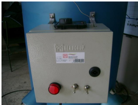
Figura 6-18: Tablero De Control
