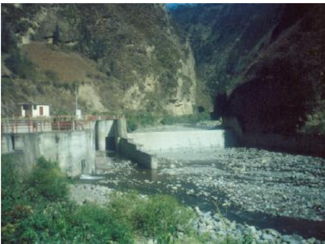
Captación del canal Ambato Huachi Pelileo.
