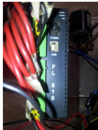
Conexión en el PLC FL 010
