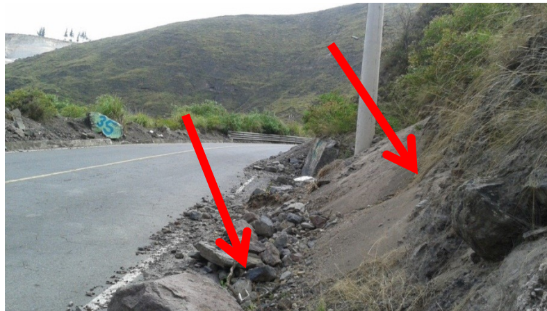
Foto 3.- Actividad de deslizamiento en la vía.
