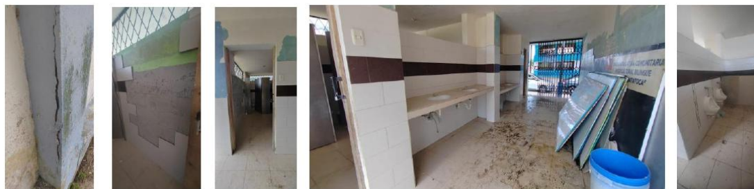
Figura 41. Imágenes de afectaciones en el módulo 8. Elaboración propia, 2025
