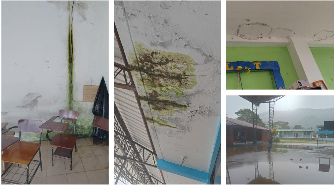
Figura 7. Problemas generados por lluvias y humedad. Elaboración propia, 2025.
