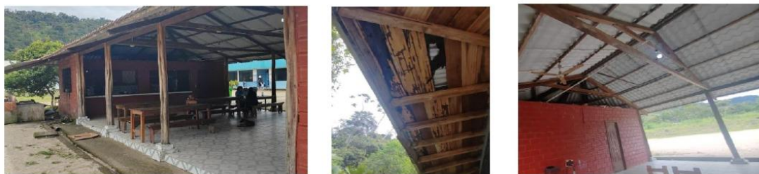
Figura 40. Imágenes de afectaciones en el módulo 7. Elaboración propia, 2025
