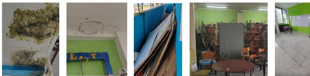
Figura 38. Imágenes de afectaciones en los módulos 2 al 5. Elaboración propia, 2025
