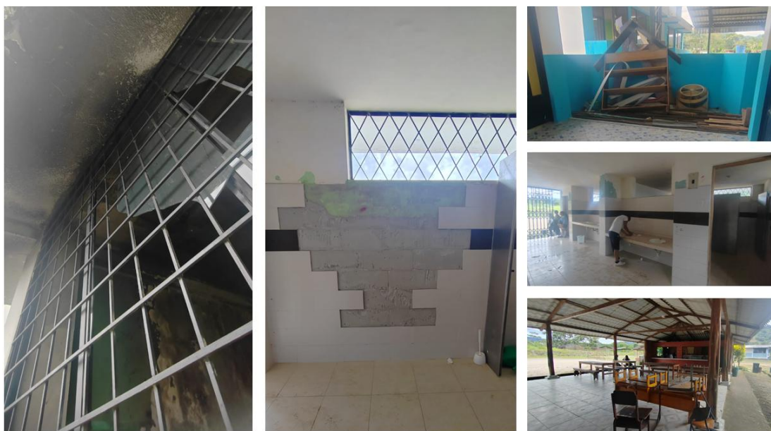
Figura 5. Deterioro y falta de mantenimiento de espacios educativos. Elaboración propia, 2025.
