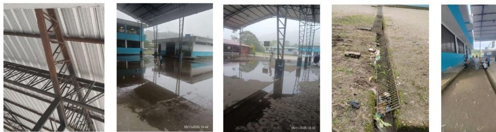
Figura 42. Imágenes de afectaciones en el módulo 9. Elaboración propia, 2025
