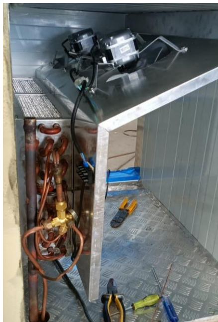
Figura 23. Interior del túnel de congelado
