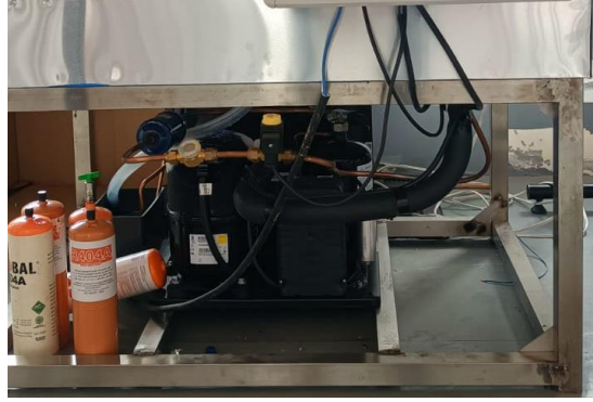
Figura 22. Sistema de refrigeración
