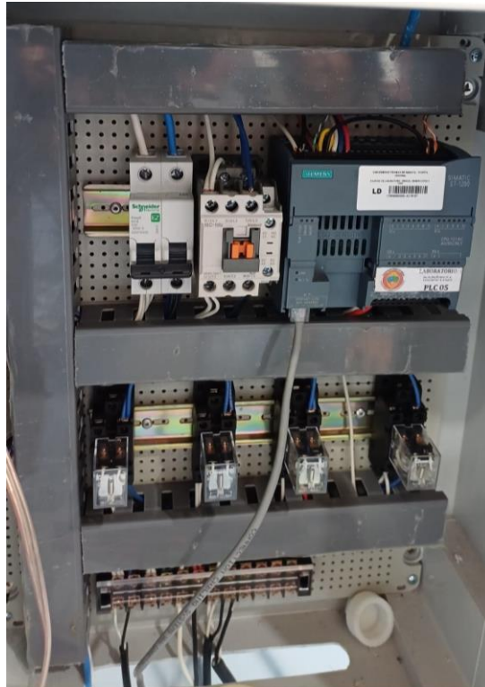
Figura 21. Interior del tablero de control
