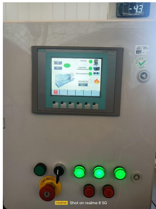
Figura 20. Tablero de control
