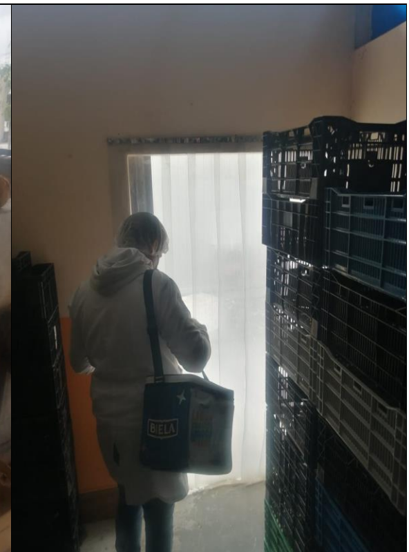
No existen puertas. Fácil acceso al interior de la planta.
