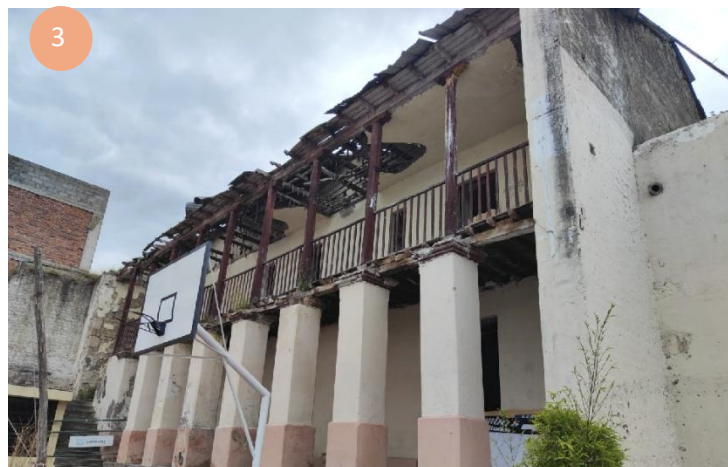
Imagen 5. Pabellón de hombres deteriorada Autoría propia (2026).
