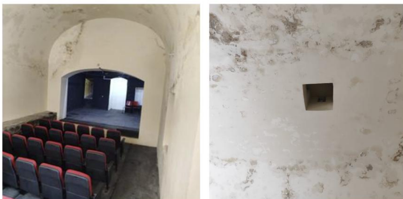
Imagen 11. Imágenes de afectaciones en el bloque 2. Elaboración propia (2026).
