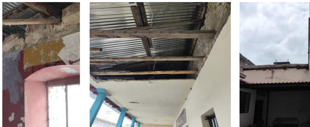
Imagen 12. Imágenes de afectaciones en el bloque 3. Elaboración propia (2026).
