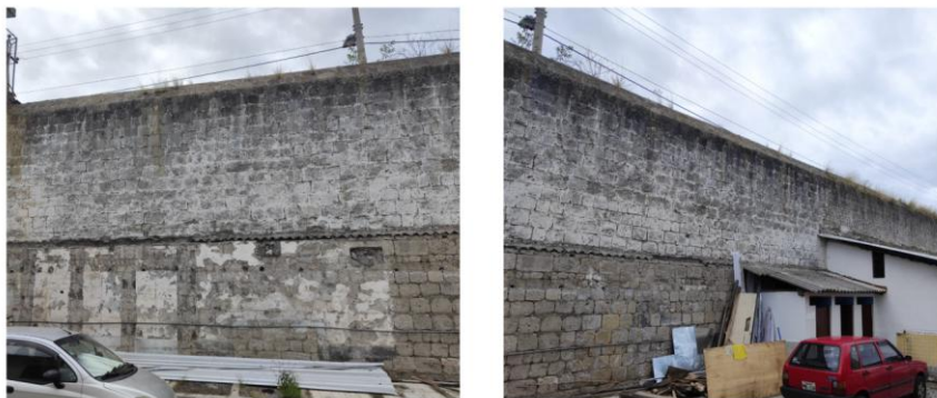
Imagen 13. Imágenes de afectaciones en el muro perimetral. Elaboración propia (2026).
