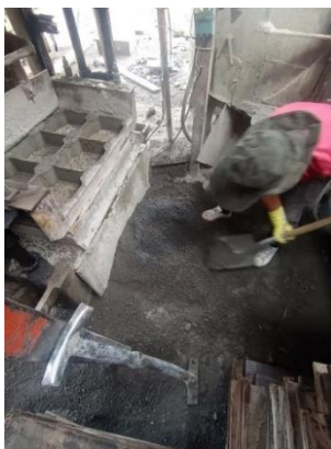
Figura 24 Mezcla de materiales con limallas.
