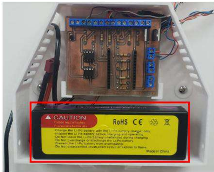
Figura 8. Batería para el respaldo de energía.
