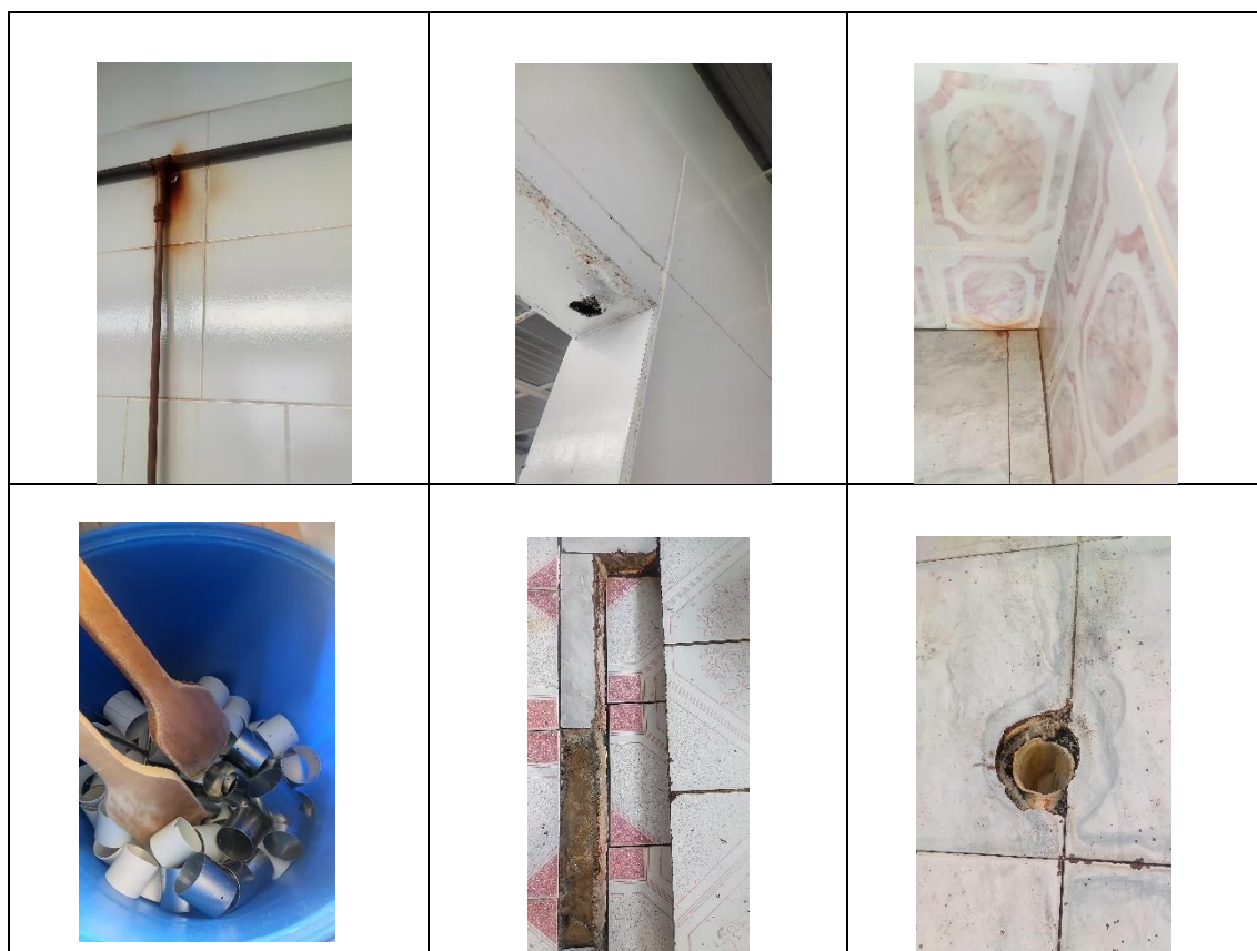
Figura 18. Registro fotográfico de las deficiencias en la planta.
