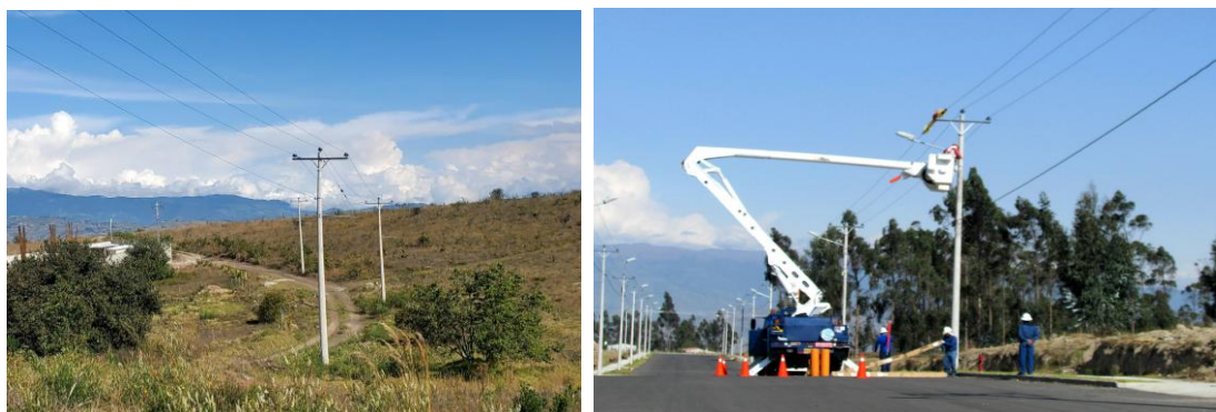
Figura 52. Instalación y presencia de infraestructura eléctrica en la zona de estudio. Fotografía: Elaboración propia (2025).
