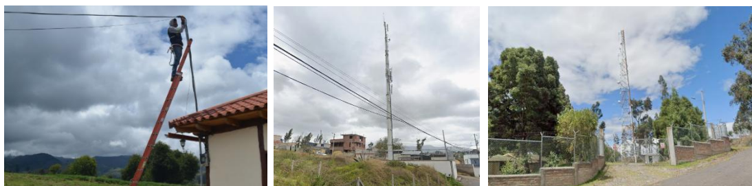
Figura 55. Infraestructura de telefonía, tv cable e internet presente en la zona de estudio. Fotografía: Elaboración propia (2025).
