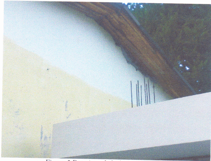
Figura 3 Deterioro de la fachada exterior
