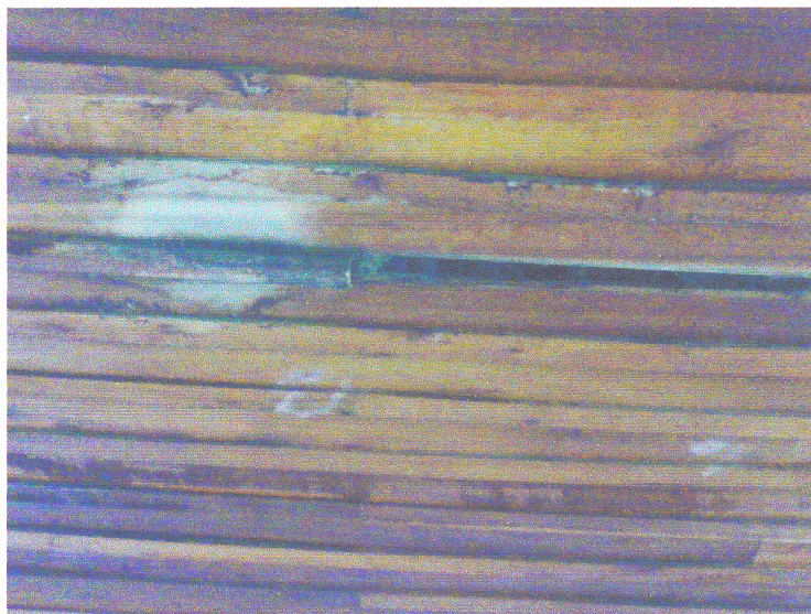
Figura 2 Fisuras graves en el tumbado
