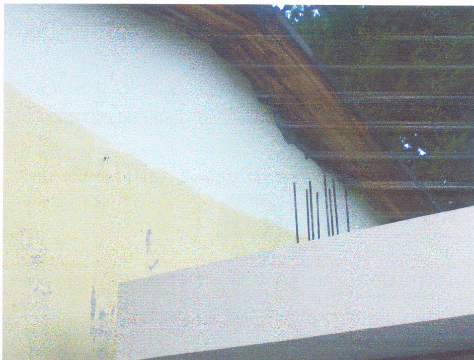
Figura 3 Deterioro de la fachada exterior
