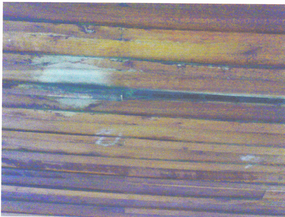
Figura 2 Fisuras graves en el tumbado
