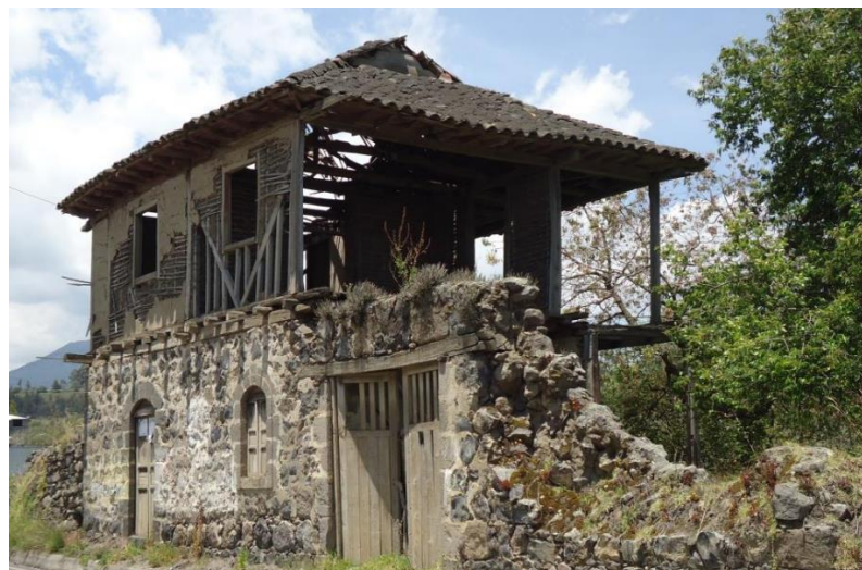
Figura 14. Bienes inmuebles en estado ruinoso. PDOT Cevallos (2011)
