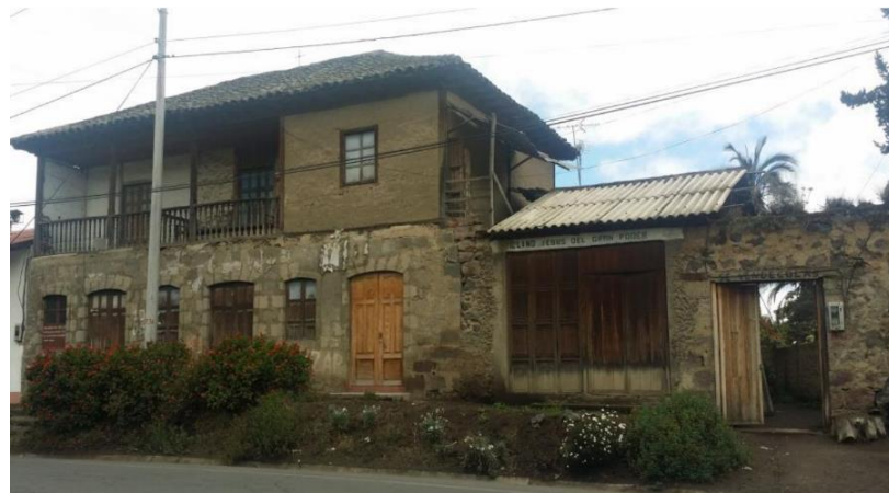
Figura 12. Bienes inmuebles en estado ruinoso. PDOT Cevallos (2011)
