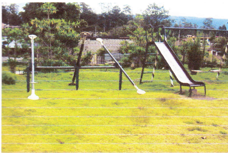
FOTO 4. Juegos recreativos deteriorados
