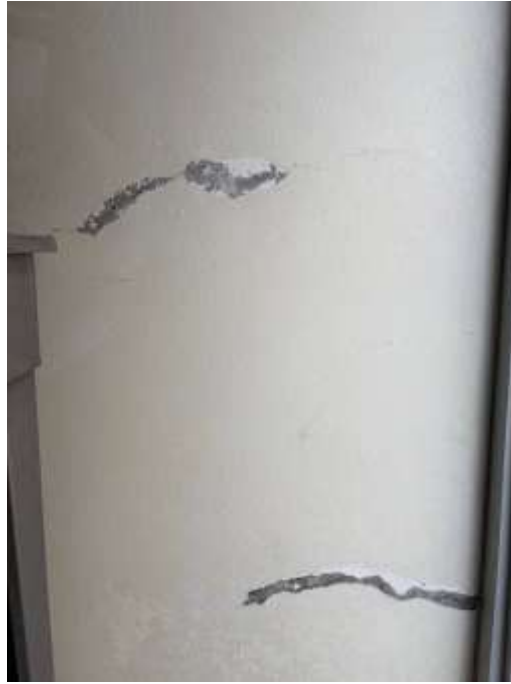
Presencia de grietas en el área de producción
