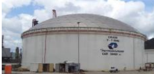
Figura 5. Tanque de techo flotante
