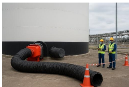
Figura 35. Ventilación y desgasificación del tanque
