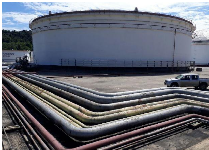
Figura 1. Tanques Verticales de Hidrocarburos
