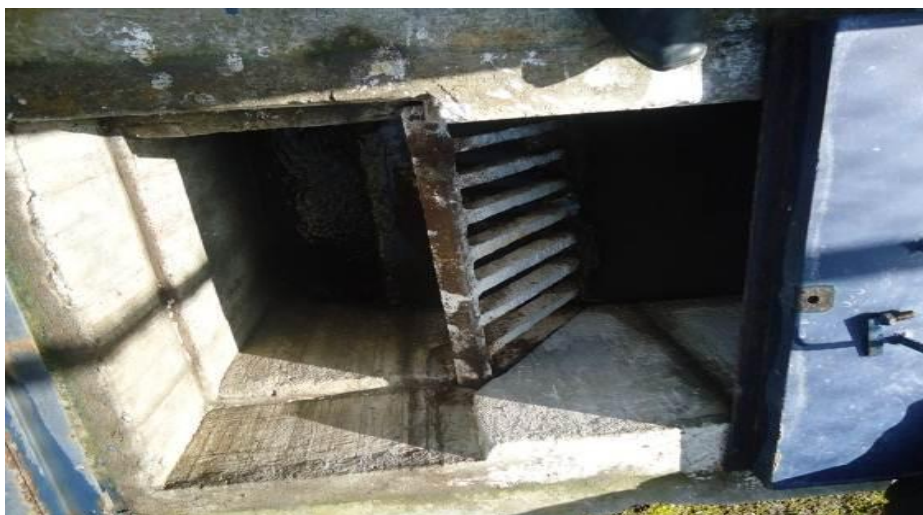
Figura 3. Rejilla de la planta de tratamiento
