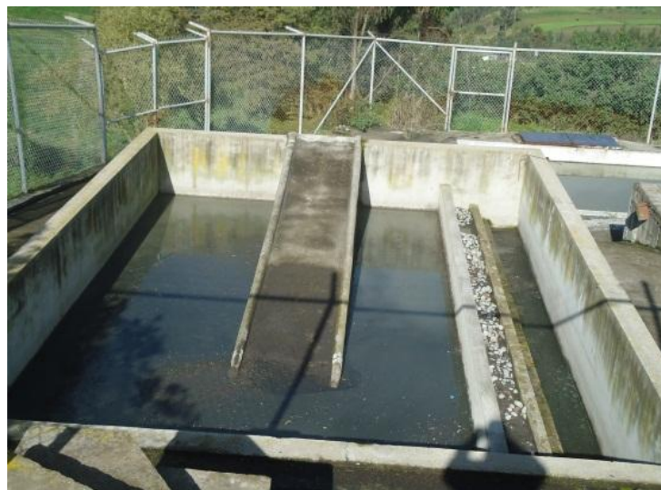
Figura 7. Lecho de secado de lodos
