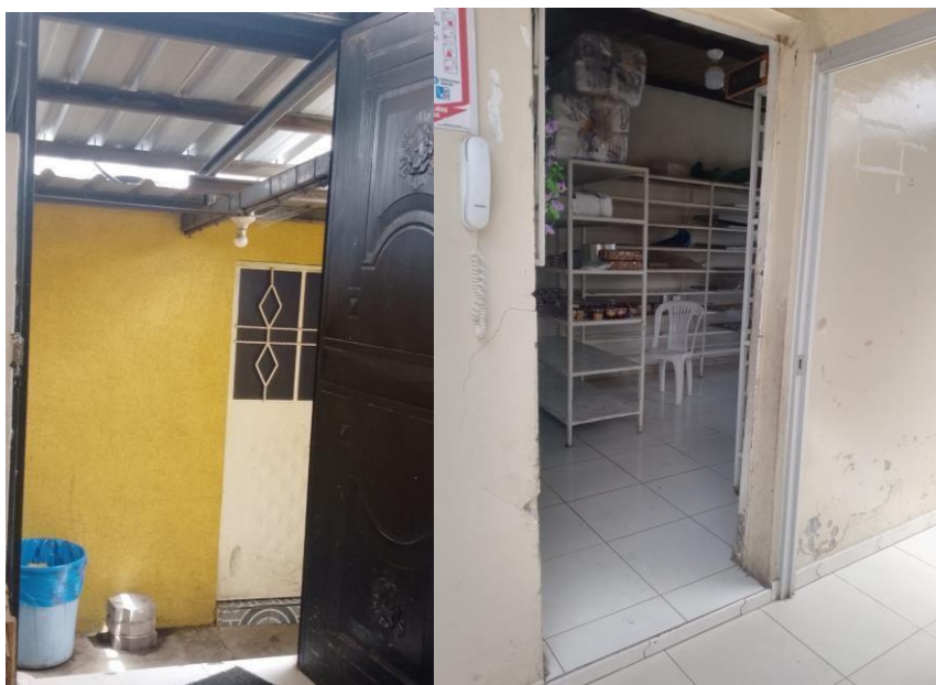
Las puertas no cuentan con cortinas PVC
