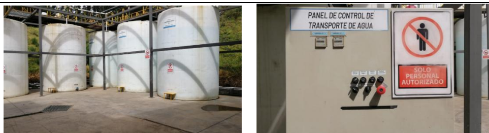
Figura 133. Tanques de reservorio y tablero de control de agua
