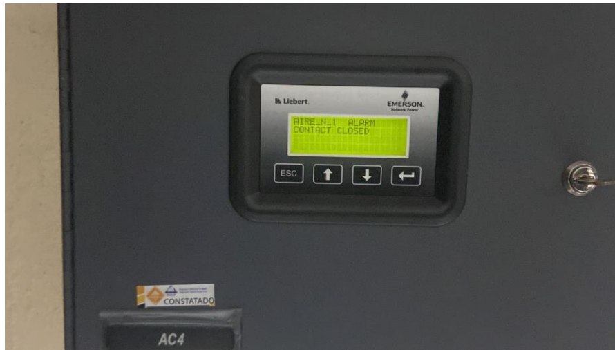
Figura 3.5: Alarma de aire del Centro de cómputo Matriz Elaborado por: El investigador.
