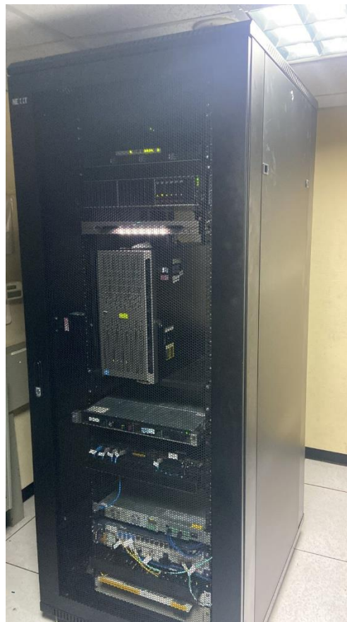
Figura 3.6: Rack de Servidores del Departamento Financiero en el Centro de cómputo Matriz Elaborado por: El investigador.
