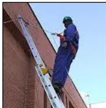
Fig. 8 Caída de personas a distinto nivel
