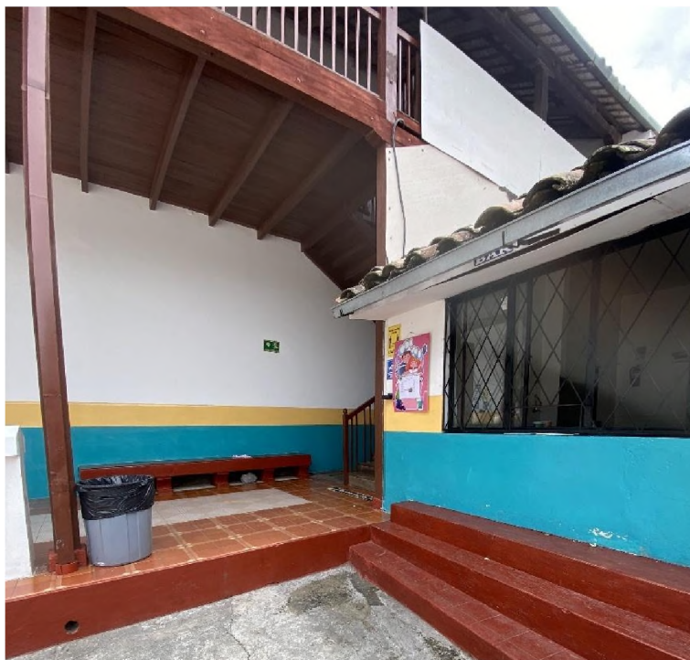
Imagen 10. Acceso a pasillo y zonas comunes con problemas de accesibilidad.
