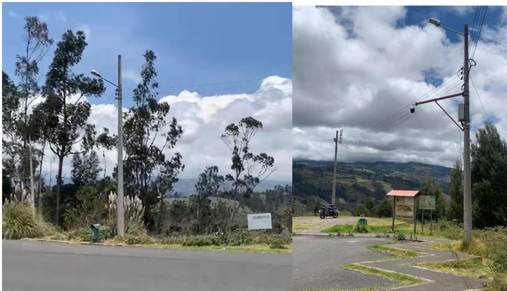
Figura 33. Postes de concreto utilizados en la red eléctrica.
