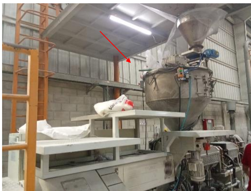
Figura 8 Riesgo de caída Peletizadora
