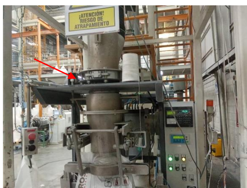
Figura 12 Riesgo de atrapamiento en válvula mariposa
