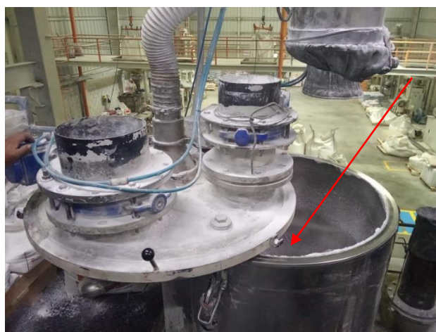
Figura 10 Riesgo de atrapamiento
