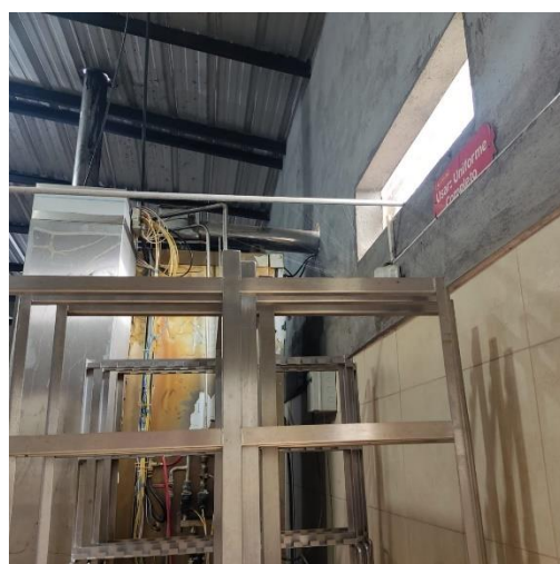
Productos apoyados directamente sobre las paredes y algunos en el piso, presencia de otros alimentos.
