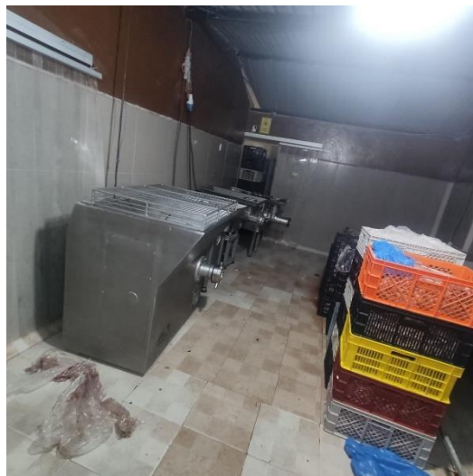
Falta de mallas protectoras en algunos drenajes
