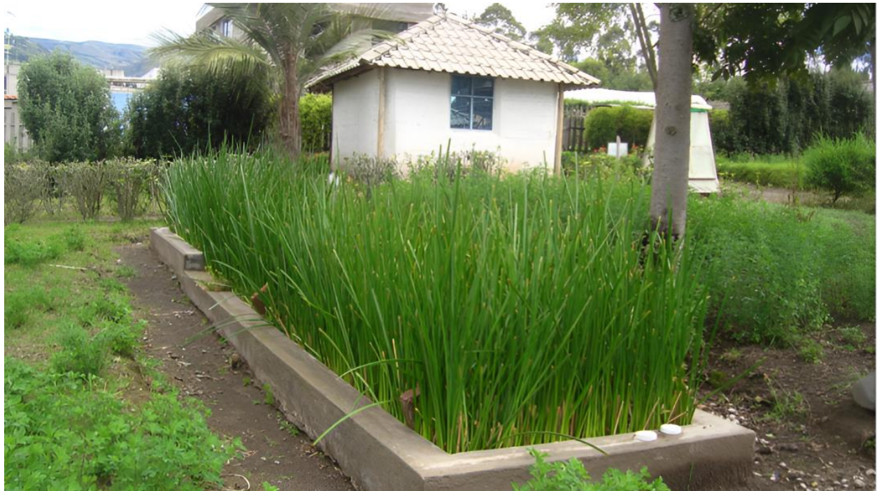
Figura 16. Sistema de tratamiento de aguas con totora
