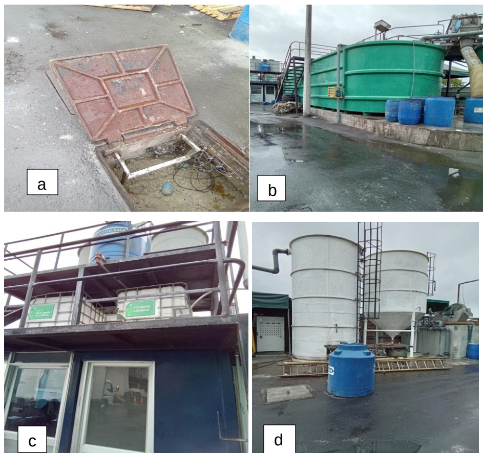
Figura 3 a) Tanque donde se unifican las 3 líneas de AR b) Tanque neutralizador c) Área de dosificación de PAC (coagulante y floculante) d) Sedimentador.
