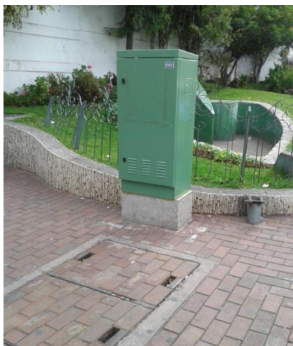
Figura 4.18 Armario en las calles Montalvo y Simón Bolívar
